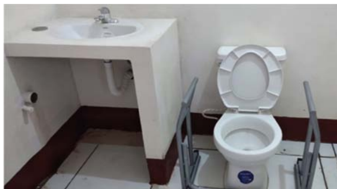
Les salles de bain désuètes et insalubres nécessitent une réfection pour répondre aux besoins d'hygiène des résidents. SOLIDARITÉ SUD coordonne et assure le suivi du projet.
